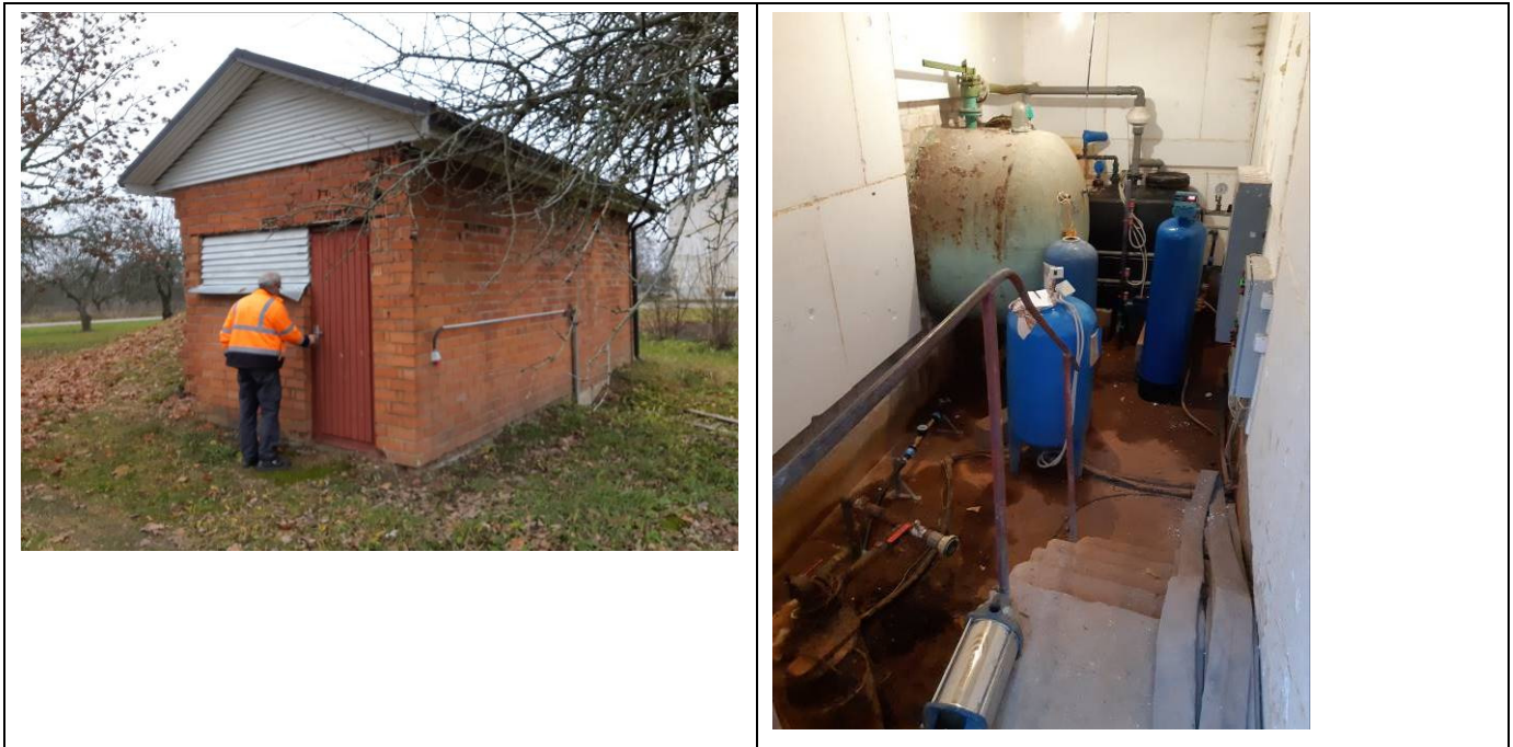
Joonis 17. Uue-Antsla küla puurkaev-pumpla (katastri nr 10764) ja veetöötusjaam. Fotod: OÜ Alkranel 07.11.2018.
