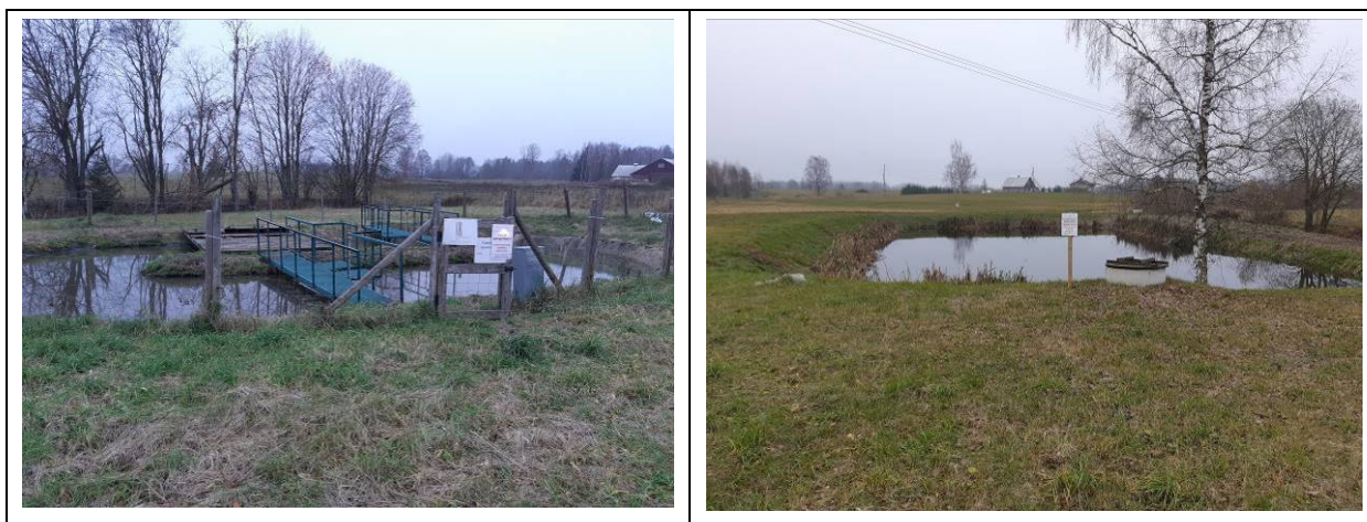
Joonis 14. Kraavi küla reoveepuhasti. Fotod: OÜ Alkranel 07.11.2018.
