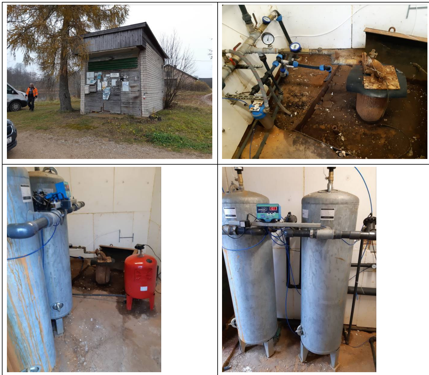
Joonis 19. Vaabina küla puurkaev-pumpla (katastri nr 10742) ja veetöötlusjaam. Fotod: OÜ Alkranel 07.11.2018.
