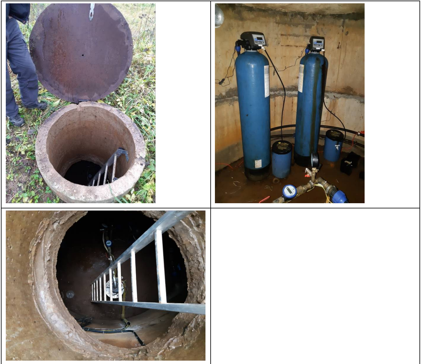
Joonis 13. Kraavi küla puurkaev-pumpla (katastri nr 10761) ja veetötlusjaam. Fotod: OÜ Alkranel 07.11.2018.
