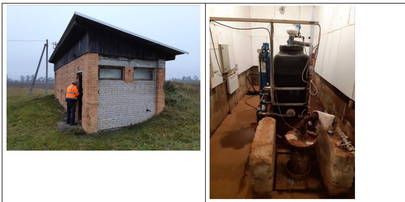
Joonis 15. Kuldre küla puurkaev-pumpla (katastri nr 10729) ja veetöötlusjaam. Fotod: OÜ Alkranel 07.11.2018.
