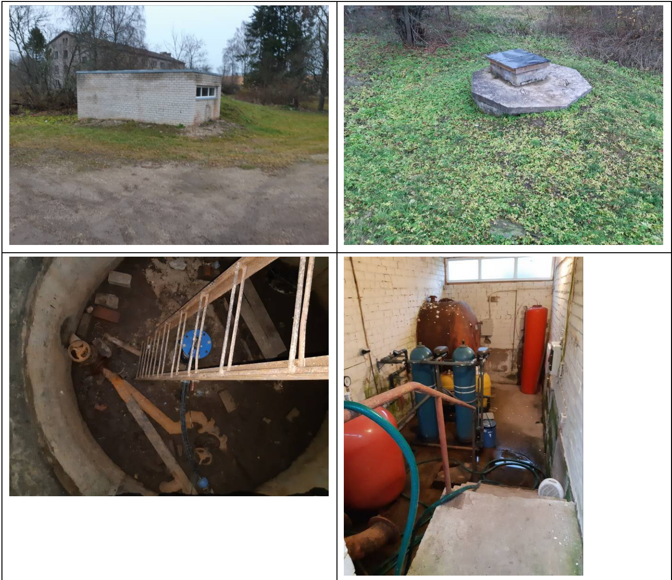
Joonis 9. Vana-Antsla aleviku puurkaev-pumpla (katastri nr 10744) ja veetötlusjaam. Fotod: OÜ Alkranel 07.11.2018.
